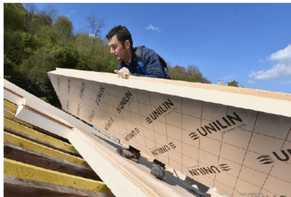
Photo d'une plaque d'isolant pour sarking qui va être déposée sur les chevrons qui constituent la charpente existante. © ARTPRIM - M. Gruss
