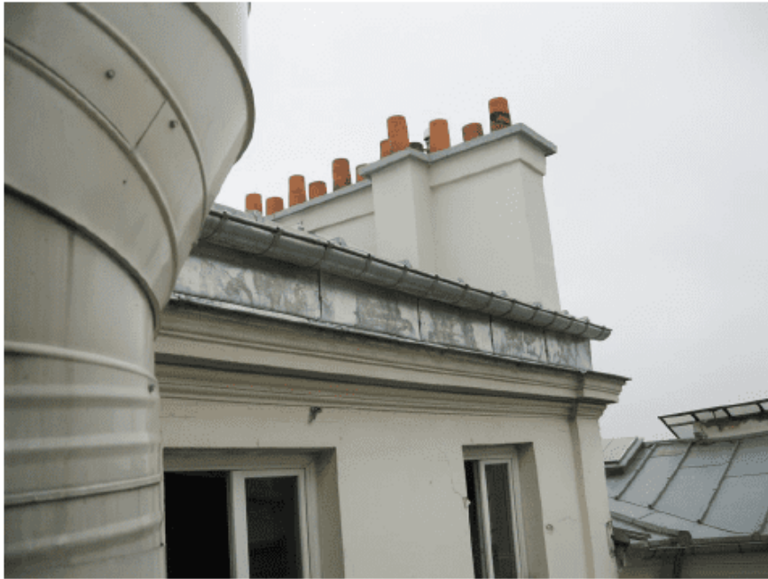
La gouttière et la corniche sont séparées par la sur-hauteur due à l'épaisseur de l'isolant. La sur-hauteur est habillée en zinc. © ARTPRIM - M. Gruss
