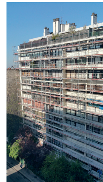
Disposition de l'échafaudage côté rue Clavel, le chantier commence ici. © Bénédicte Courbey
