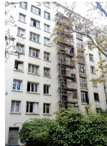
Façade sur cour de l'immeuble : vue sur la sapine permettant de monter l'isolant dans les combles © Gaëtan Brisepierre
