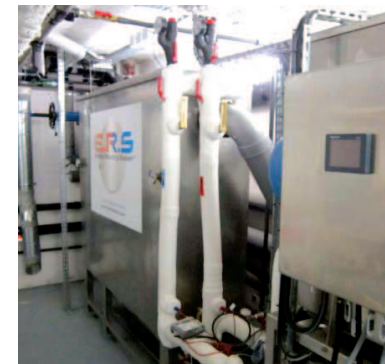
Le système de récupération d'énergie sur eaux grises, ERS. © L-BA – Living and Building Archishop
