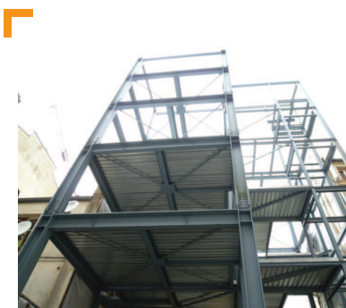
Façade sur jardin cour intérieure (Sud-Ouest) - Structure métallique achevée © North by Northwest
