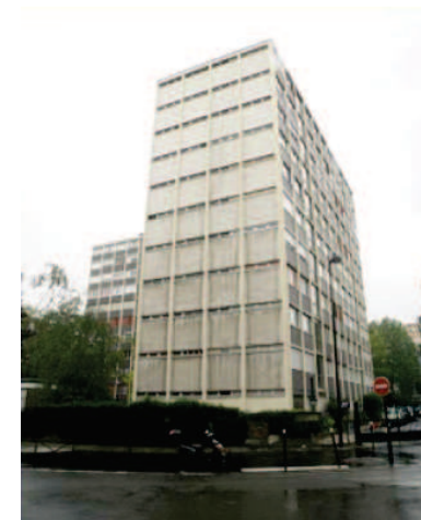
Mur pignon qui sera isolé par l'extérieur avec une résistance thermique de 4.4m 2 .K/W © Cabinet IDF Architecture
