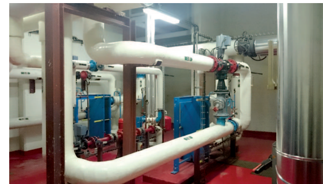
Sous-station CPCU avec, en arrière-plan, l'un des échangeurs et les circuits de distribution © Fabrice Fouriaux
