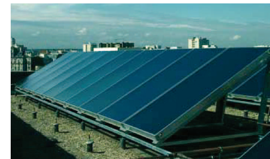
Capteurs solaires en toiture terrasse, plein sud, inclinés à 45° © Paris Habitat
