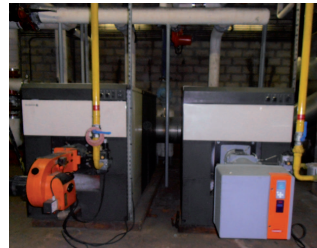
Chaudières de la copropriété 119 rue des Pyrénées © Sunsquare
